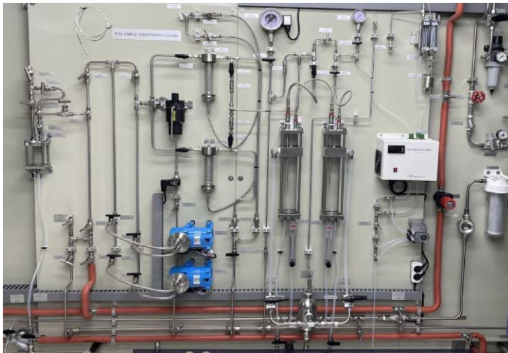
- 시료 전처리 장치 (Sample Conditioning System) -
