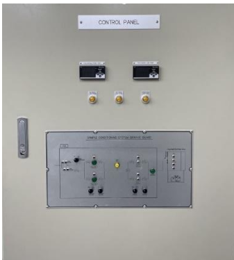
- 자동제어 장치 (Control Panel) -
